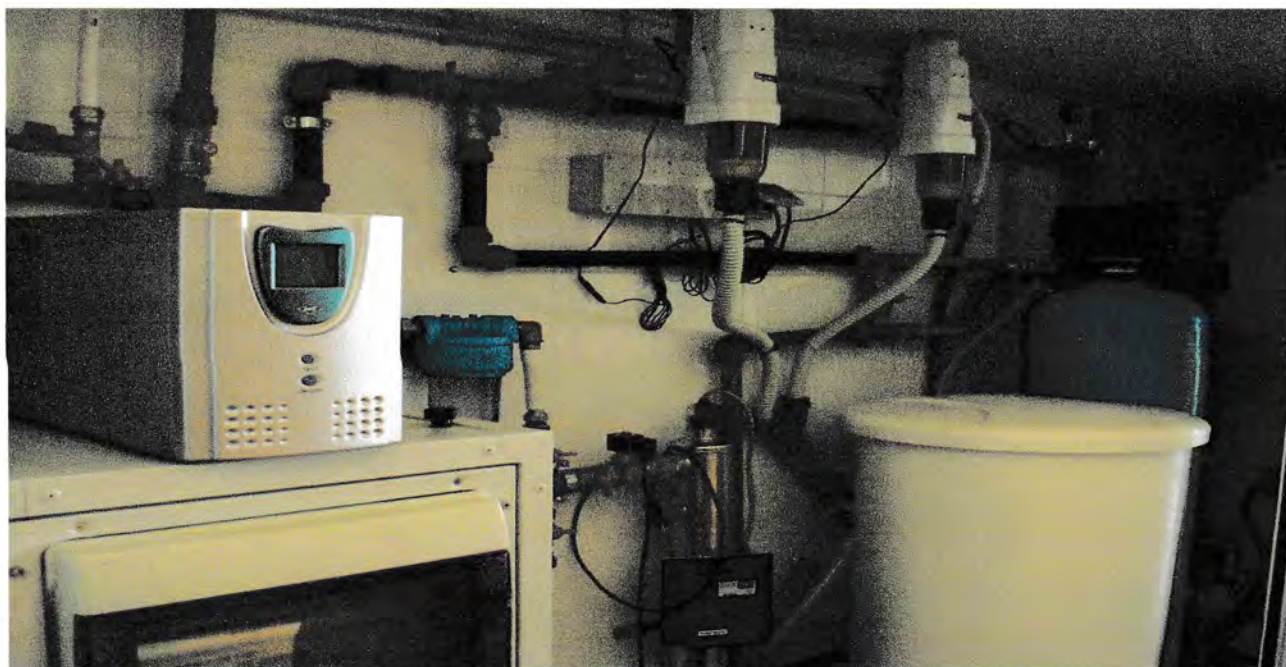
IMPIANTO INTERNO TRATTAMENTO ACQUA
