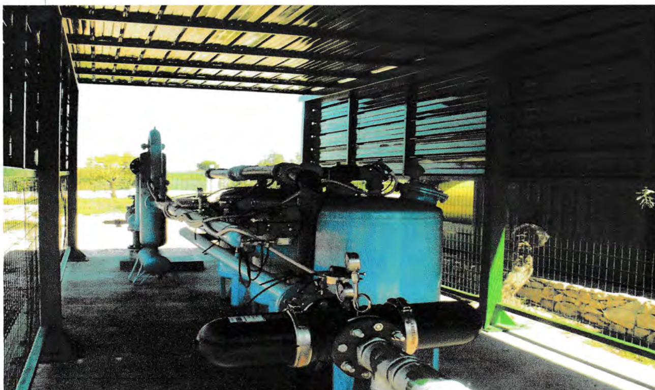
POZZO ARTESIANO CON FILTRAZIONE PRIMARIA
